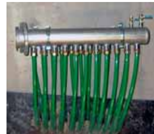
Rakennuksen sisälle asennettu sulanapitojakotukki.
